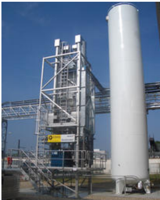
Instalación de DuoCondex en una planta de producción farmacéutica de Ile-de-France.
